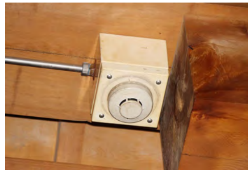
正殿内(3階)の煙感知器
