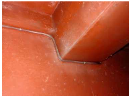
正殿内の熱感知器(空気管式)
