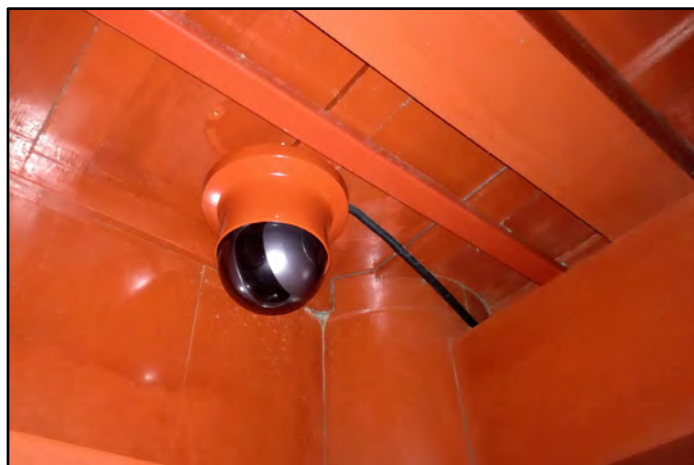
正殿内の監視カメラ
