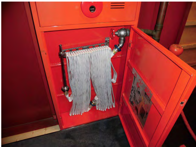
1号消火栓 <焼失前：正殿2階北側>
