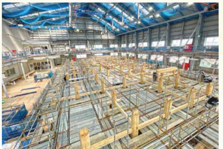
令和8年秋の完成を目指し首里城正殿本体工事が素屋根内で行われている。首里城正殿復元整備工事 建方工事(令和5年10月16日)
