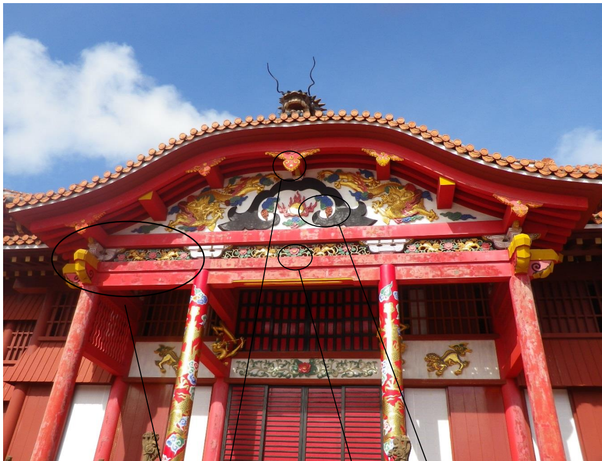
【 首里城正殿外部的塗漆、顏色劣化及金箔剝落的情況 】
