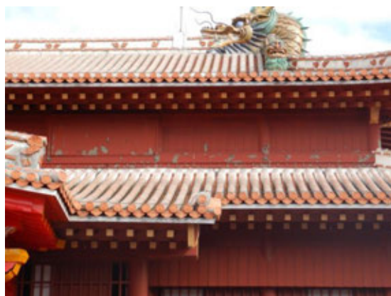
【外壁部 漆剥落】
