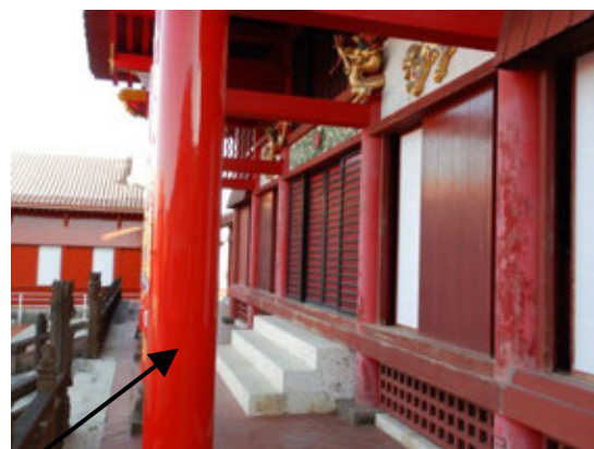
【向拜内侧柱、敷居(门坎) 漆劣化】
