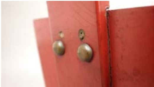
立上り竹釘部分 修理前
