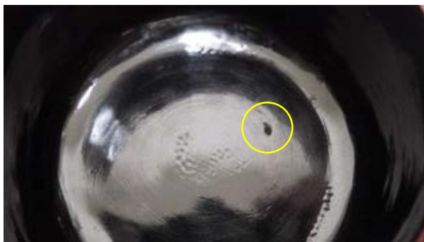
図8-1 三段目見込み塗膜剥離
