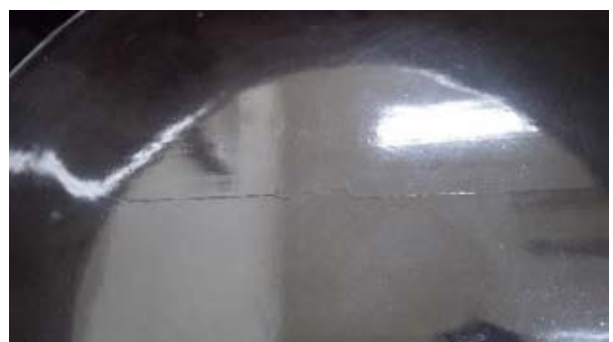
図8 天板裏の亀裂
