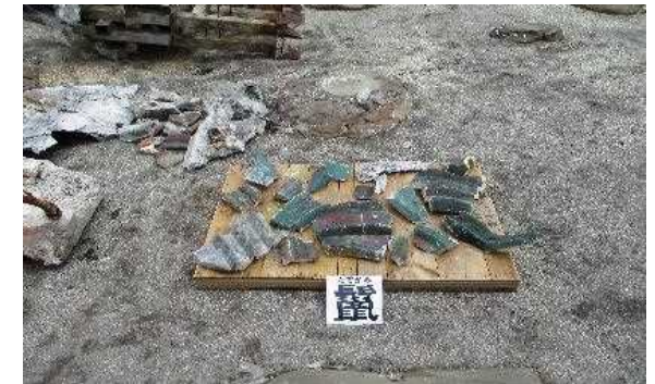
破損した龍頭棟飾の一部
