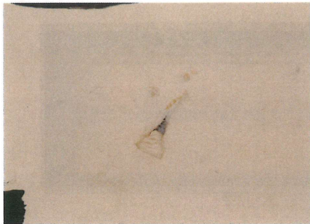
写真16 修復前・破損箇所(部分)
