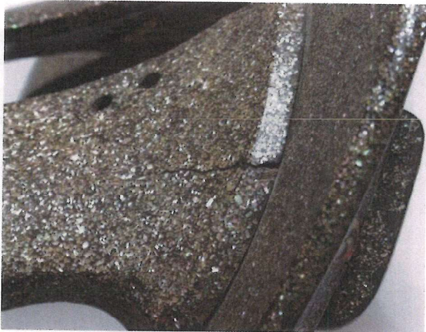
修復前 居木 後輪側
