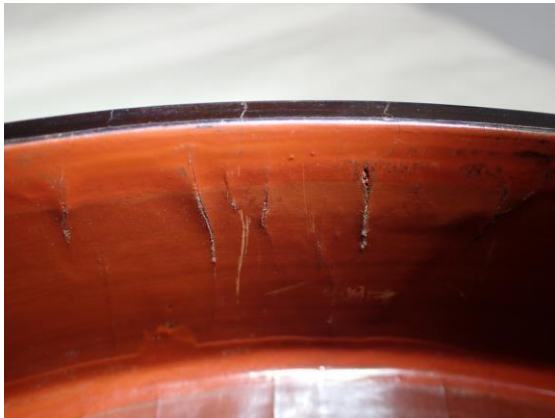
図 4 内面 塗膜の亀裂・剥離
