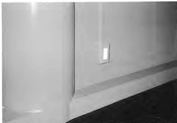
2階壁付コンセント
