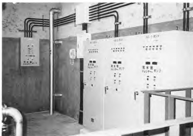
ポンプ室制御盤
