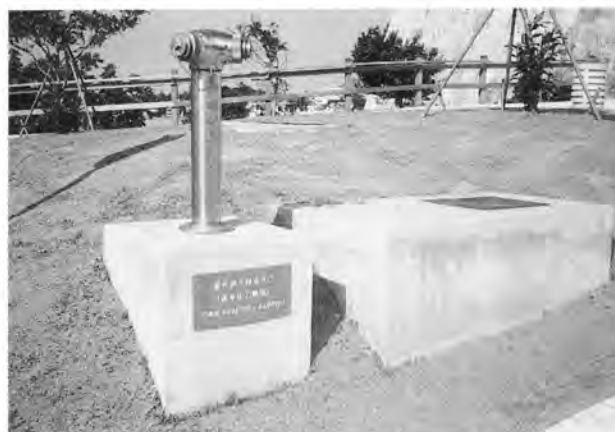
消防隊専用送水口 (木曳門側)
