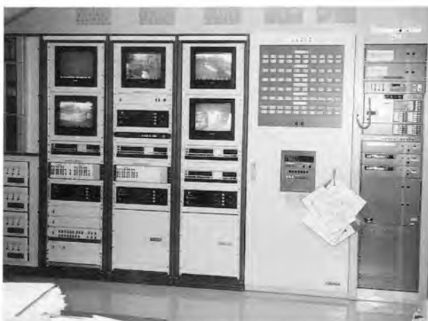
奉神門監視盤（住宅・都市整備公団が整備）
