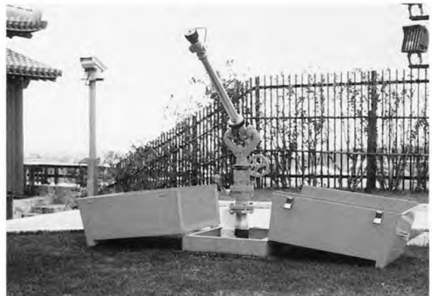
地上設置型放水銃
