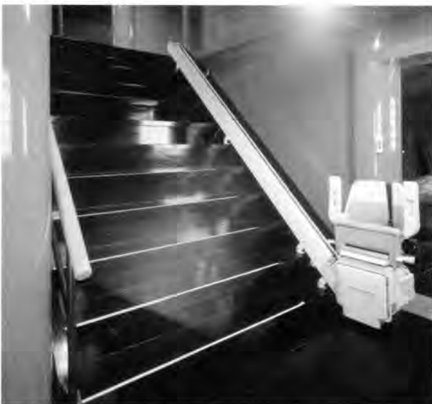
正殿に取付られた斜行リフト
