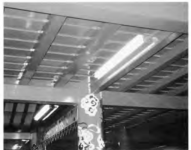
1階御差床照明
