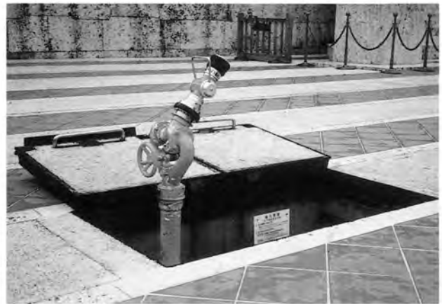
地下設置型放水銃
