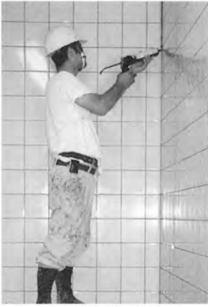
便所内部 タイルシーリング
