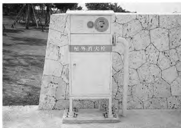
屋外消火栓 (広福門側)
