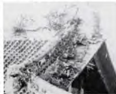
写真-1 昭和修理前の入母屋破風
