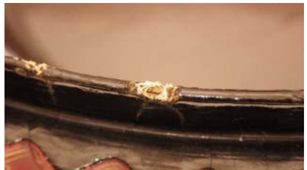
図5-3 立上り欠損部
